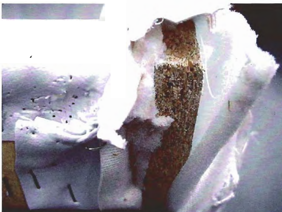
Idem, outro detalhe. Além disso, a fixação da estrutura metálica Ao assento e encosto não está conforme foi especificado.
